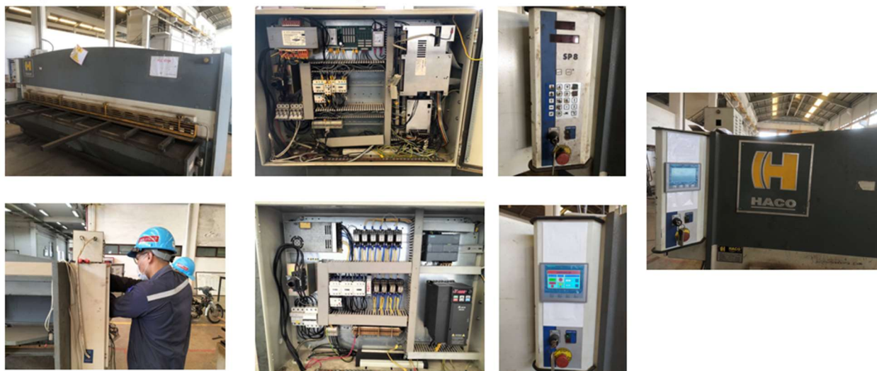
รูปที่ ๒๗ การปรับปรุงระบบควบคุมเหล็กตัดแผ่นโลหะด้วยระบบไฮดรอลิกส์ รง.โลหะแผ่น กอง รง.เรือเหล็ก อรม.อ.
