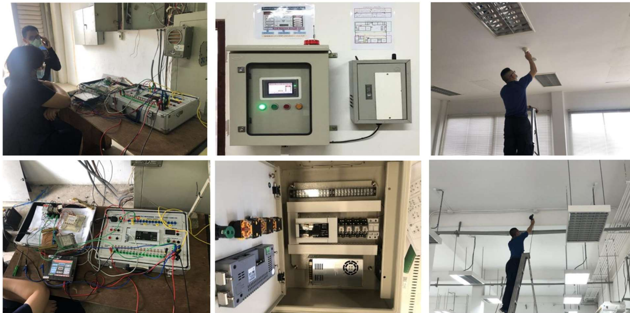
รูปที่ ๒๖ การปรับปรุงระบบแจ้งเตือนเหตุเพลิงไหม้ภายในอาคาร กฟฟ.อรม.อ. ผ่าน Line Application
