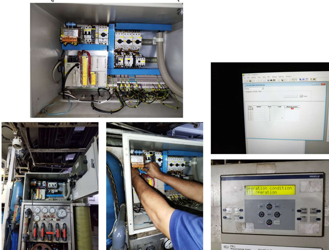
รูปที่ ๒๐ ตรวจสอบและซ่อมระบบควบคุมเครื่องผลิตน้ำจืดจากน้ำทะเลด้วยระบบ Reverse Osmosis ชุด ร.ล.ปัตตานี
